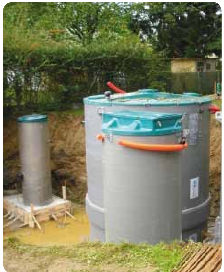
Station Bartouilles à Gelos
