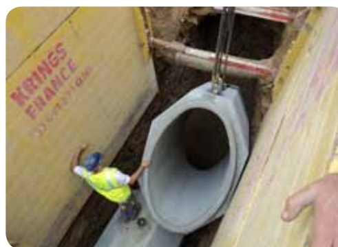
Travaux de pose de buse en béton pour la réalisation d'un collecteur de transit des eaux usées.
